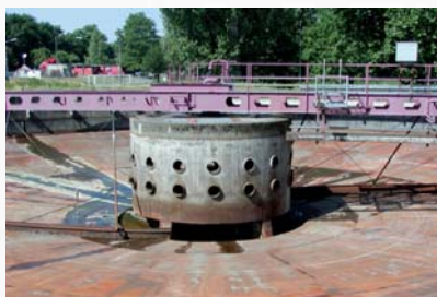
Bassins de décantation intermédiaire
