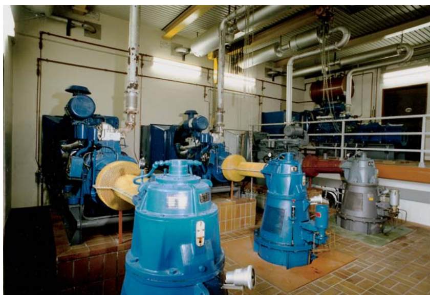
Pompes d'eau de pluie immergées
