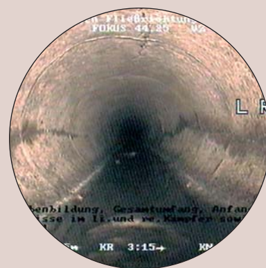
Canal endommagé avant l'assainissement
