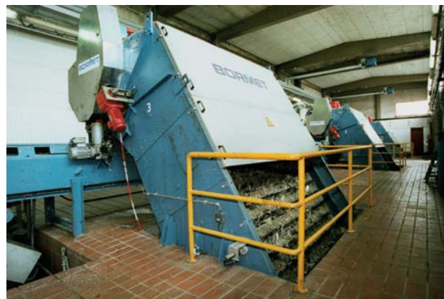
Dispositif de grille de retenue automatique, 1993
