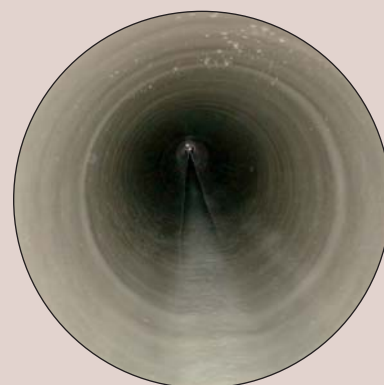
Après l'assainissement : le canal est recouvert de plastique renforcé avec des fibres de verre
