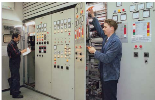
Salle de contrôle de la station de pompage « Südtangente »
