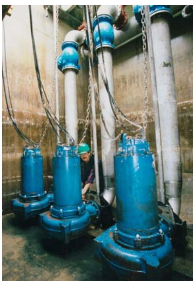
Puits de pompage avec des pompes immergées
