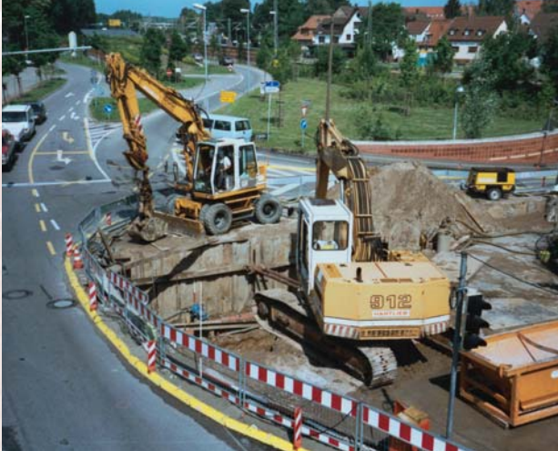
Entraves à la circulation lors d'un chantier de construction à ciel ouvert
