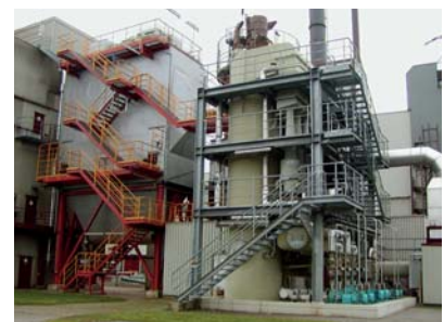
Nettoyage des effluents gazeux
