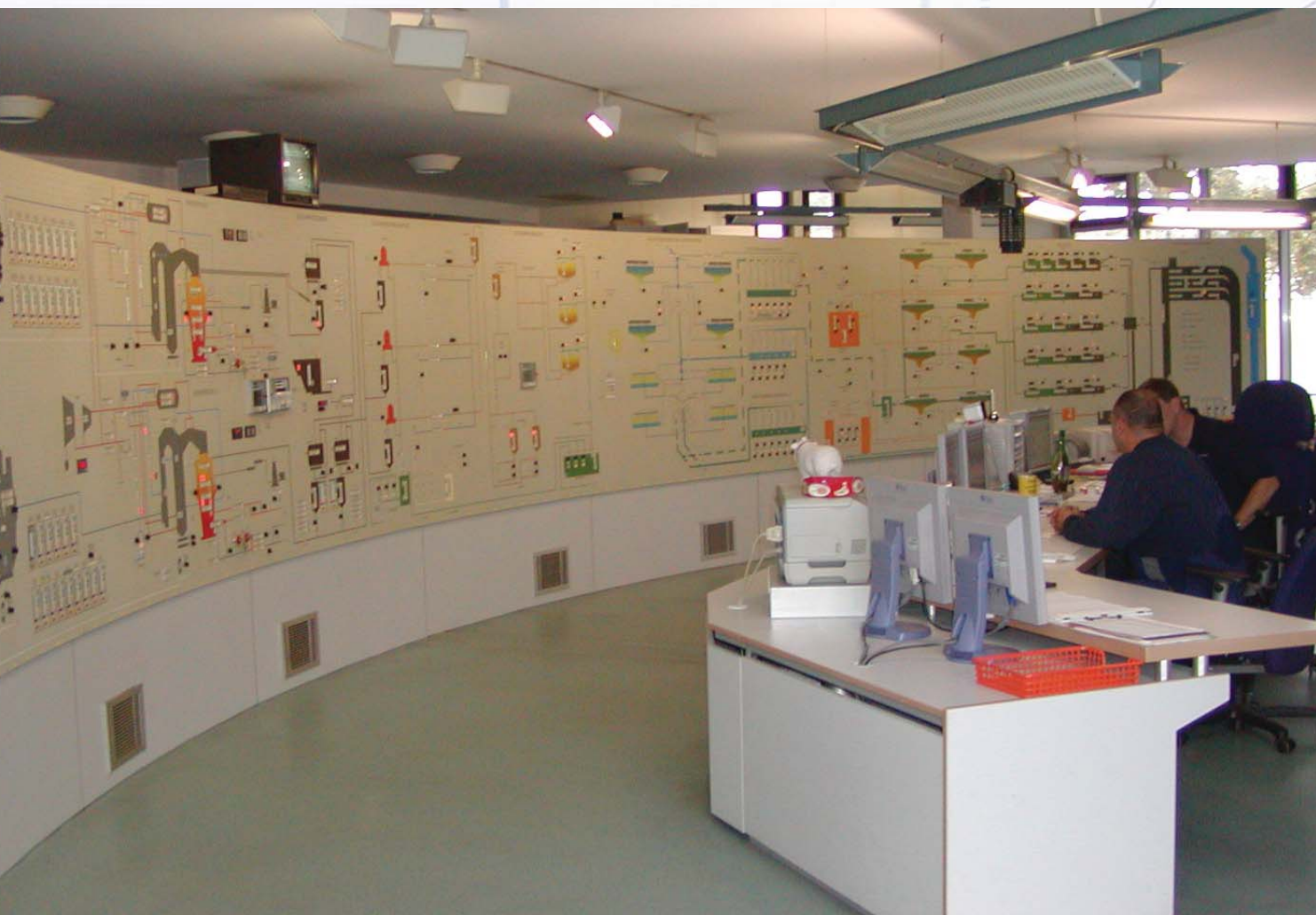
Centre de contrôle de la station d'épuration
