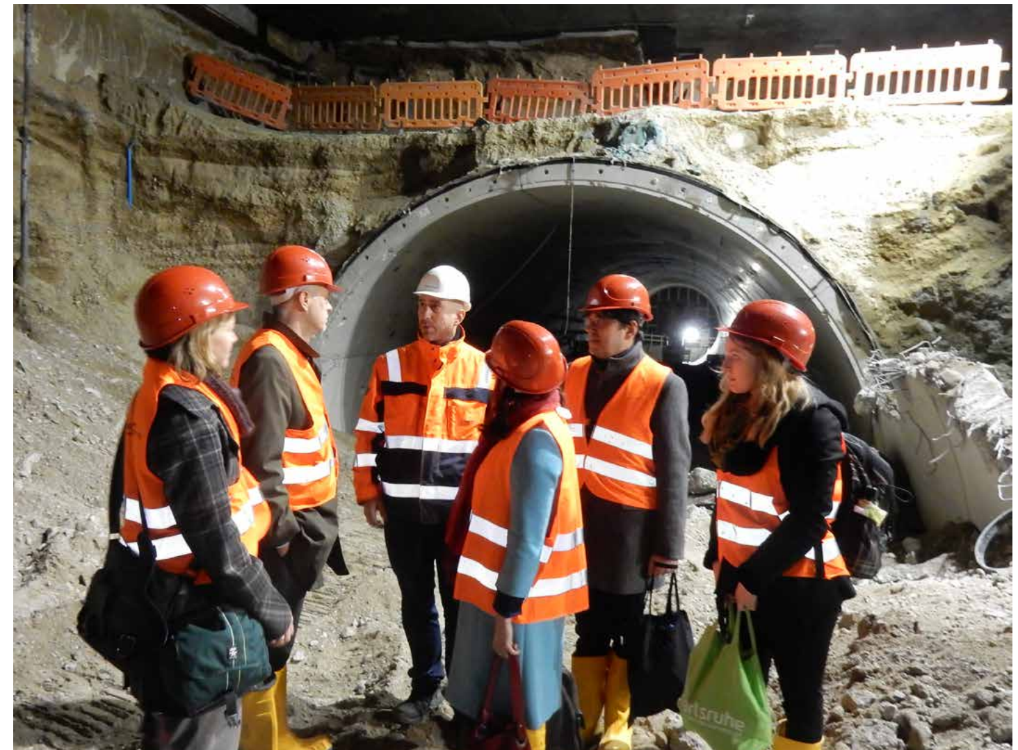
Leader of the Council und stellvertretende Chief Executive aus Nottingham bei Baustellenführung unter dem Marktplatz Karlsruhe 2016, (2. v. l.), Foto: Liane Wilhelm, Stadt Karlsruhe
