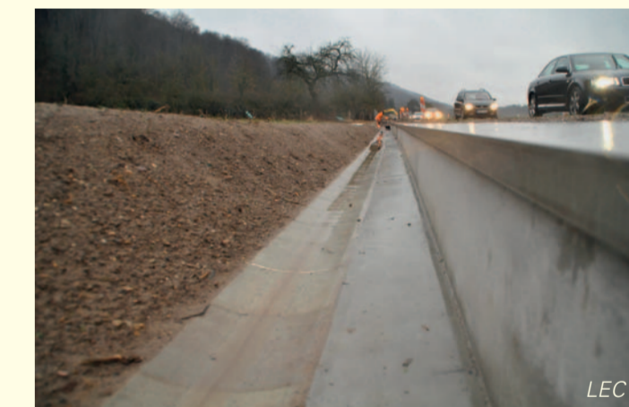
Die Amphibienleiteinrichtung ermöglicht Amphibien die Wanderung vom Winterquartier im Bergwald zu ihren Laichgewässern und verhindert so ein Amphibien-Massensterben auf der vielbefahrenen Bundesstraße.
